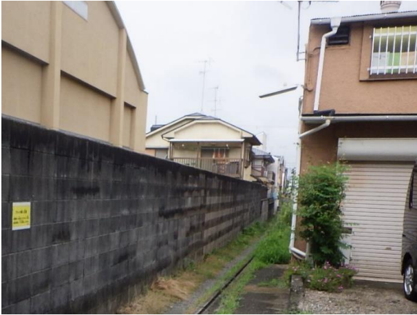
附属高等学校ブロック塀対策
